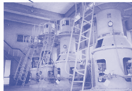
立軸軸流ポンプ 口径700mm 60kw/台 揚水量70m 3 /分/台×4台 内3台は翼角制御装置装備 ディーゼル発電機250kw 1台
