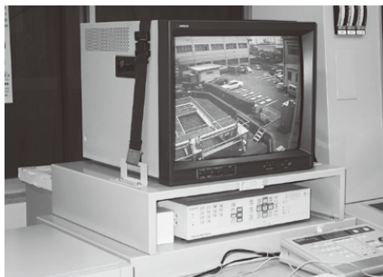
CCTV監視システム
