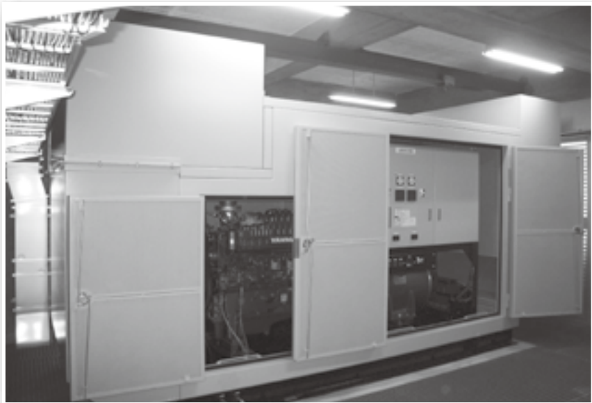
更新後の自家発電機（出力：300KVA）
