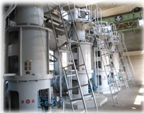
主ポンプ 揚水量 70 m 3 /分/台
